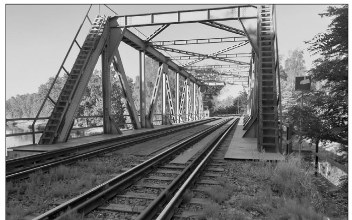
Bild 7 Die Brücke für die Werkbahn über den Oder-Spree-Kanal zum Werk (Foto Detlef Malzahn)
